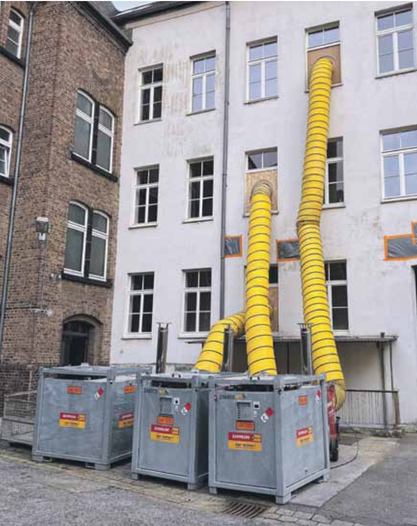
Die intelligente, bedarfsgerechte Heizlösung für die Sanierung des denkmalgeschützten Rathauses der Stadt Mönchengladbach umfasste moderne Heizaggregate, die rein mit HVO100 betrieben wurden. Foto: Zeppelin Rental
