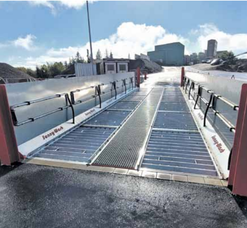
Reifenwaschanlage von Sunny-Wash, angetrieben von leistungsstarken Tsurumi-Pumpen.
