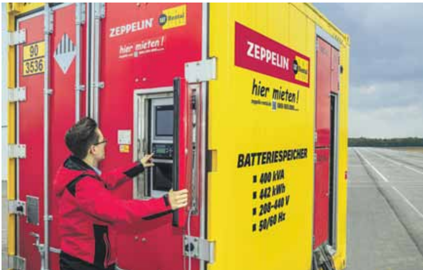
Kern der Anlage ist ein Batteriespeicher mit einer Leistung von 400 kVA. Fotos: action press/Peter Seyfferth
