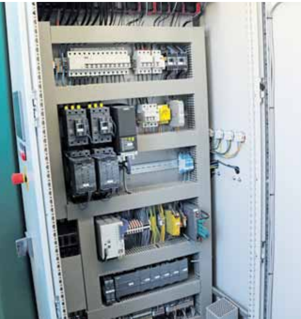
Digitales Bindeglied zwischen den Funktionen bildet die SPS-Steuerung.
