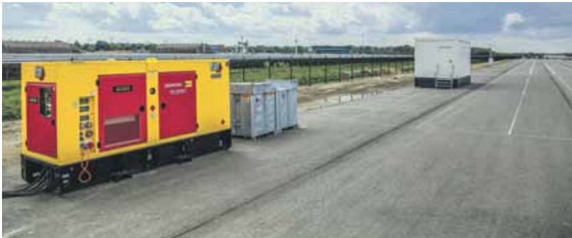
Sinkt der Ladezustand des Batteriespeichers auf 30 Prozent, startet automatisch der 310-kVA-Generator und lädt den Batteriespeicher.
